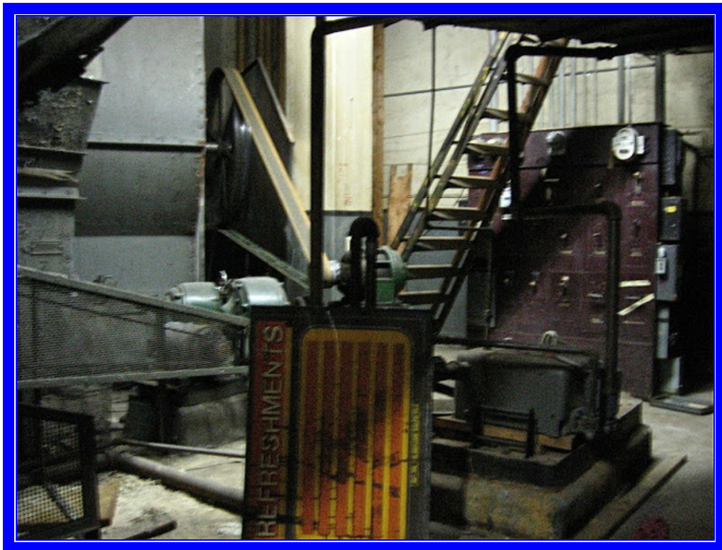
Balcony supply air fan
