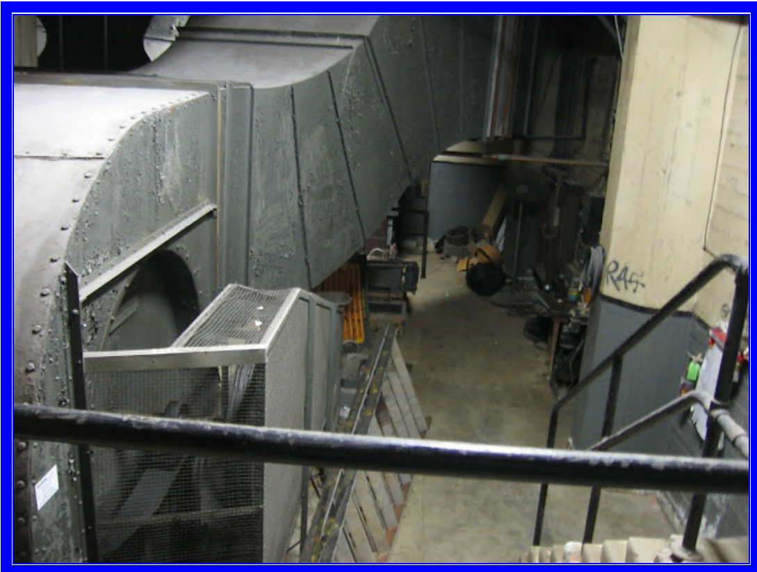
The fan room
