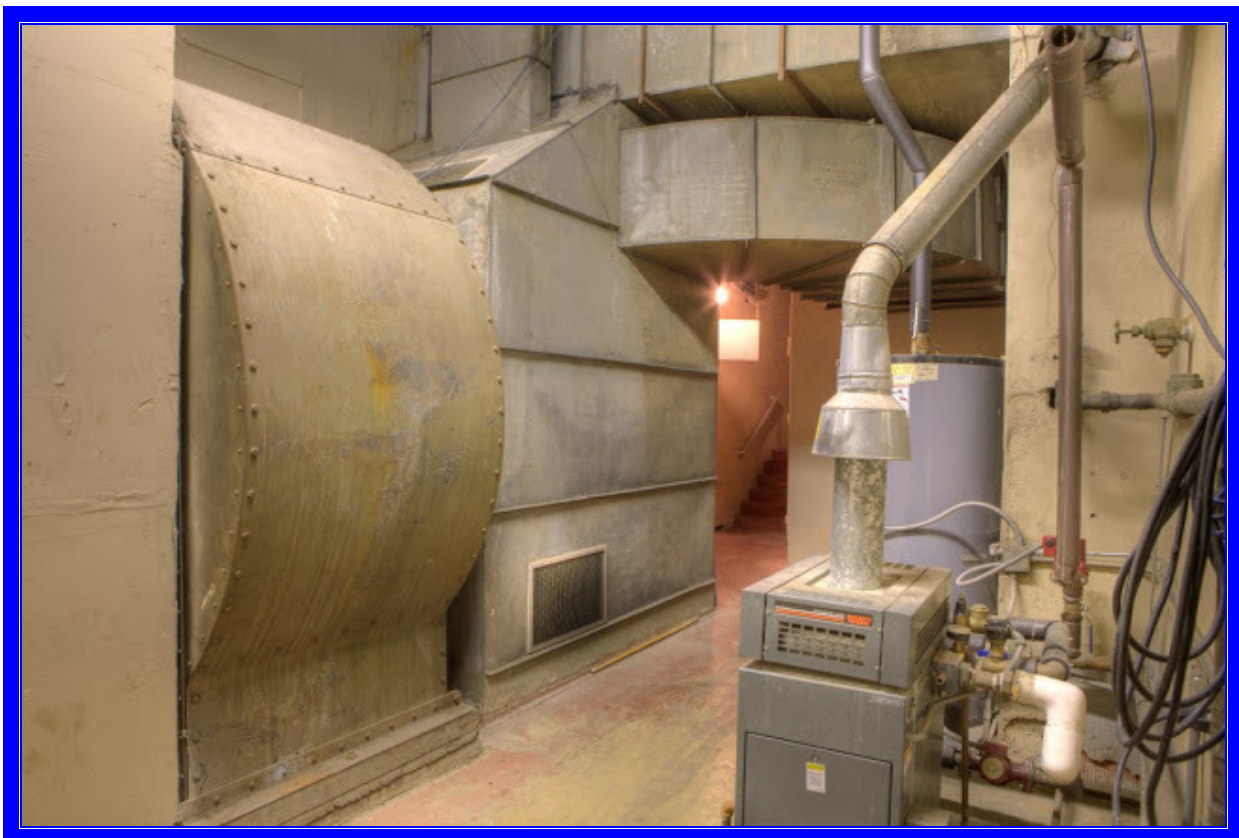
Centrifugal fan sets
