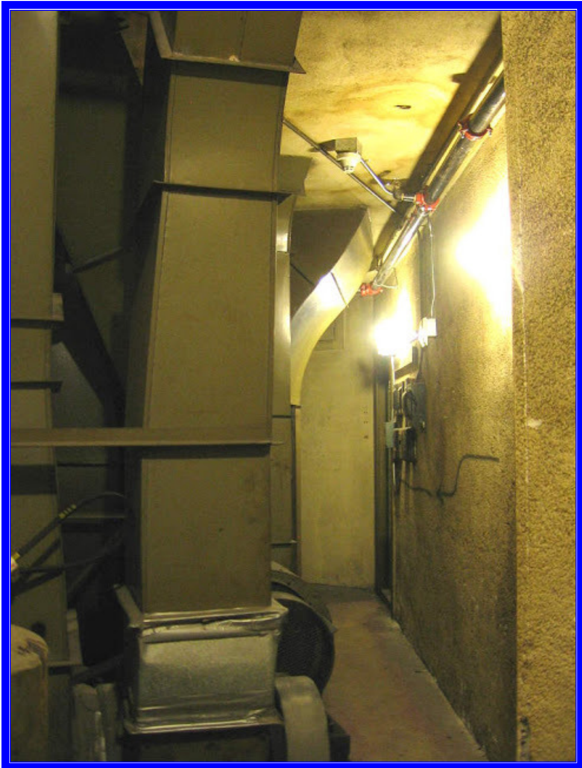
Upstairs fan room
