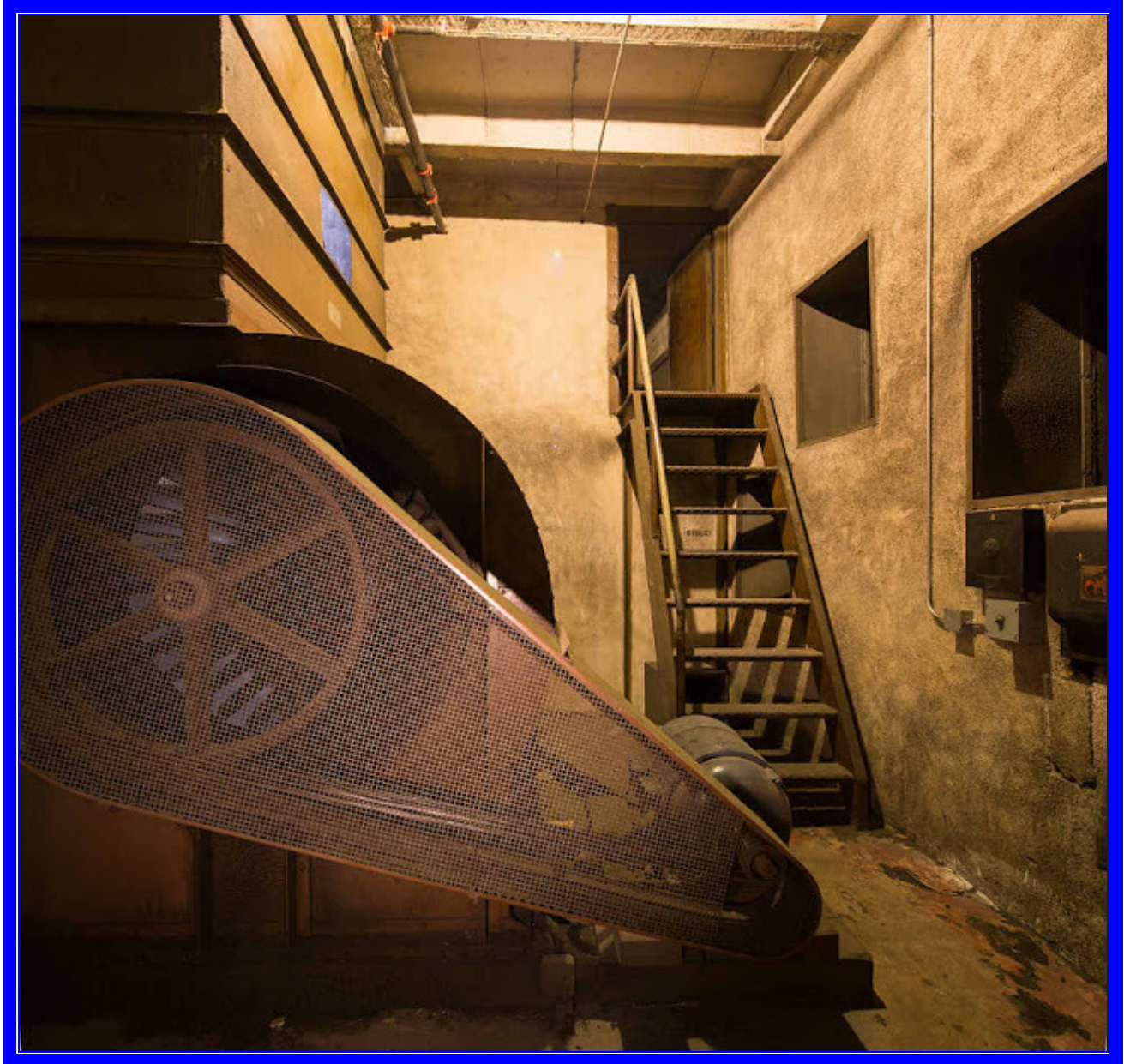
Main exhaust fan
