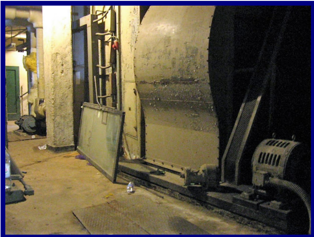
Main supply fan
