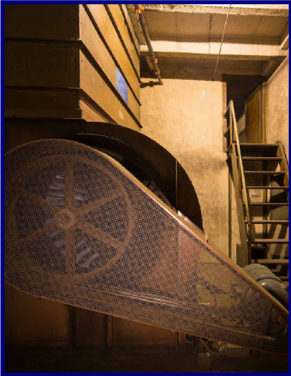
Main exhaust fan
