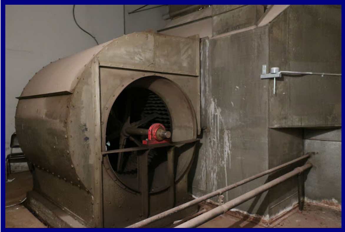
Centrifugal supply fan
