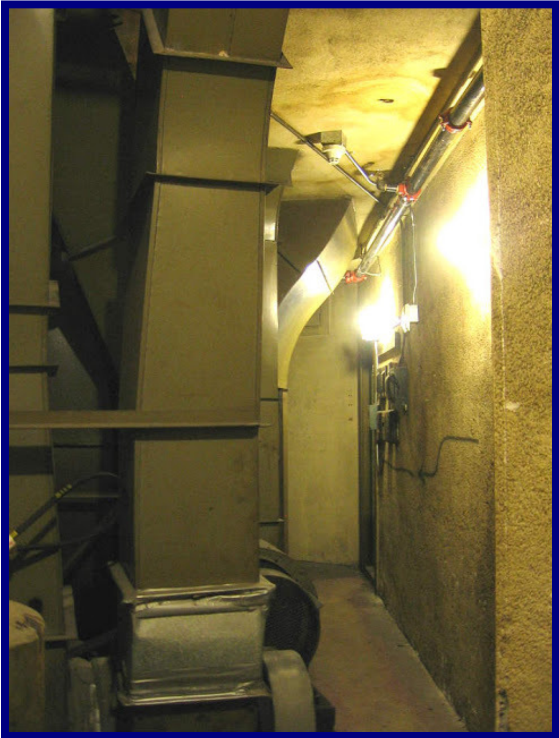
Upstairs fan room
